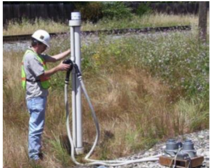
噪音和震動監控設備範例
